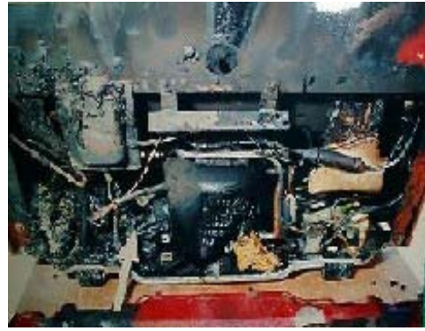
写真2 ねずみの尿がかかって発火した 電気機器の基盤部分
