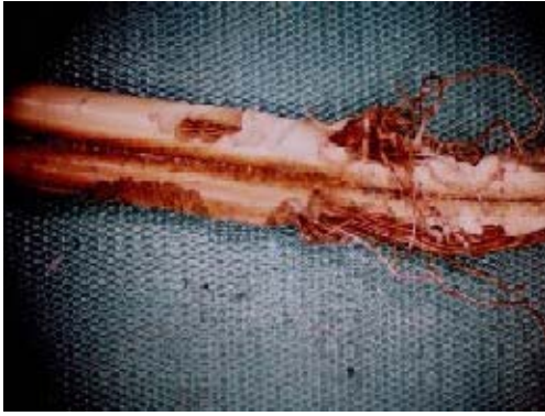
写真1 齧られた電気コード (写真提供: 1, 2とも東京消防庁)
