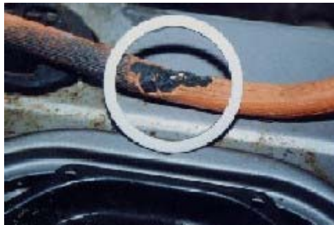
写真3 ねずみに齧られたガス管(写真提供: 東京消防庁)
