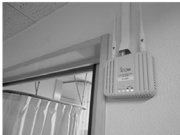
(写真.4)各居室入口に設置した Wi-Fi ルーター
