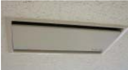
天井に設置されたロスナイ
