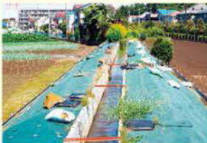
土地の高低差をなくして、用水の水が流れるように土手を作った様子がわかります。
